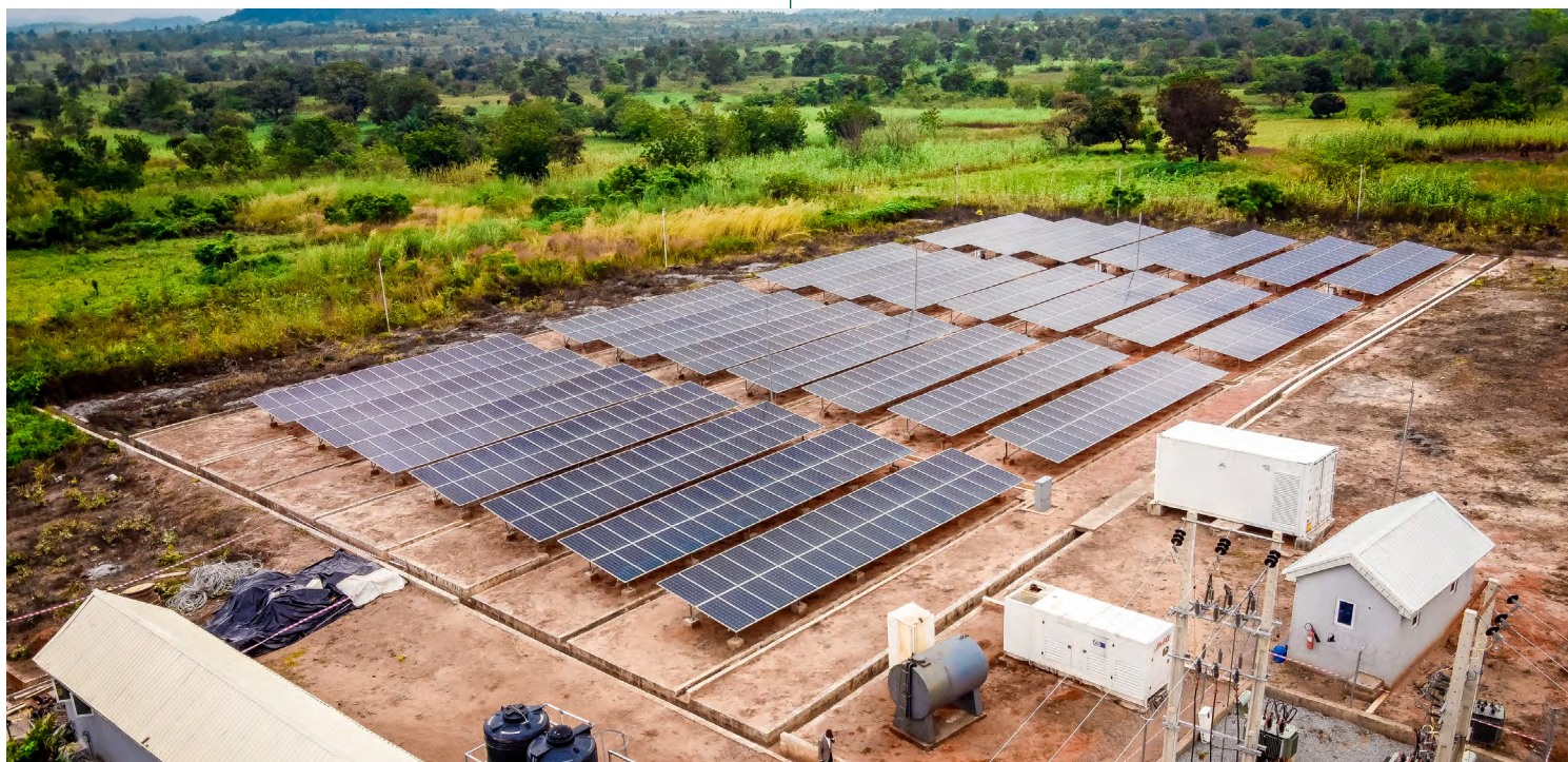
Toto interconnected mini grid in Nigeria.
